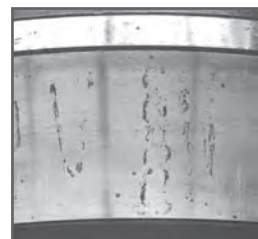
Ржавчина и коррозия
